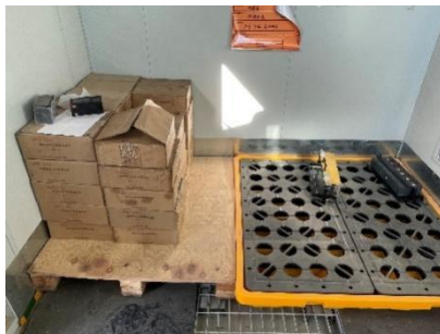
废铅蓄电池存放处
